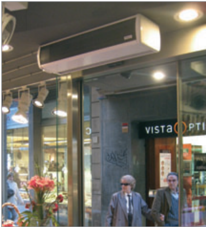
Optima Einbau in einem Einkaufszentrum
