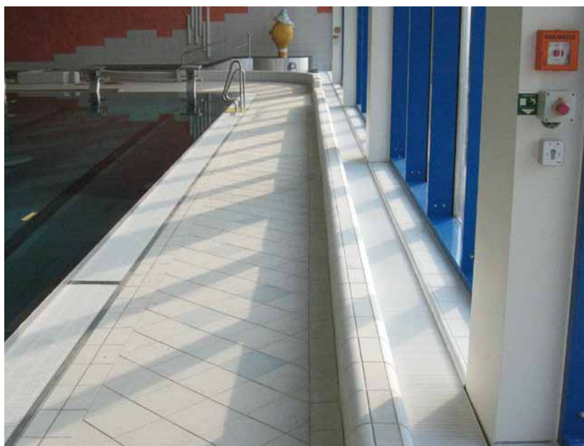
emco Rost Typ 730 in Verbindung mit emcotherm Bodenkonvektoren in einem Schwimmbad in Würzen
